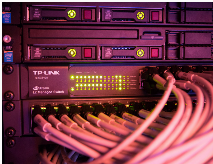
TL-SG5428 для работы с изображением и звуком в телевещательной станции.
