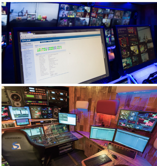
2 коммутатора управляют всеми потоками данных (Источник: TV Skyline)
